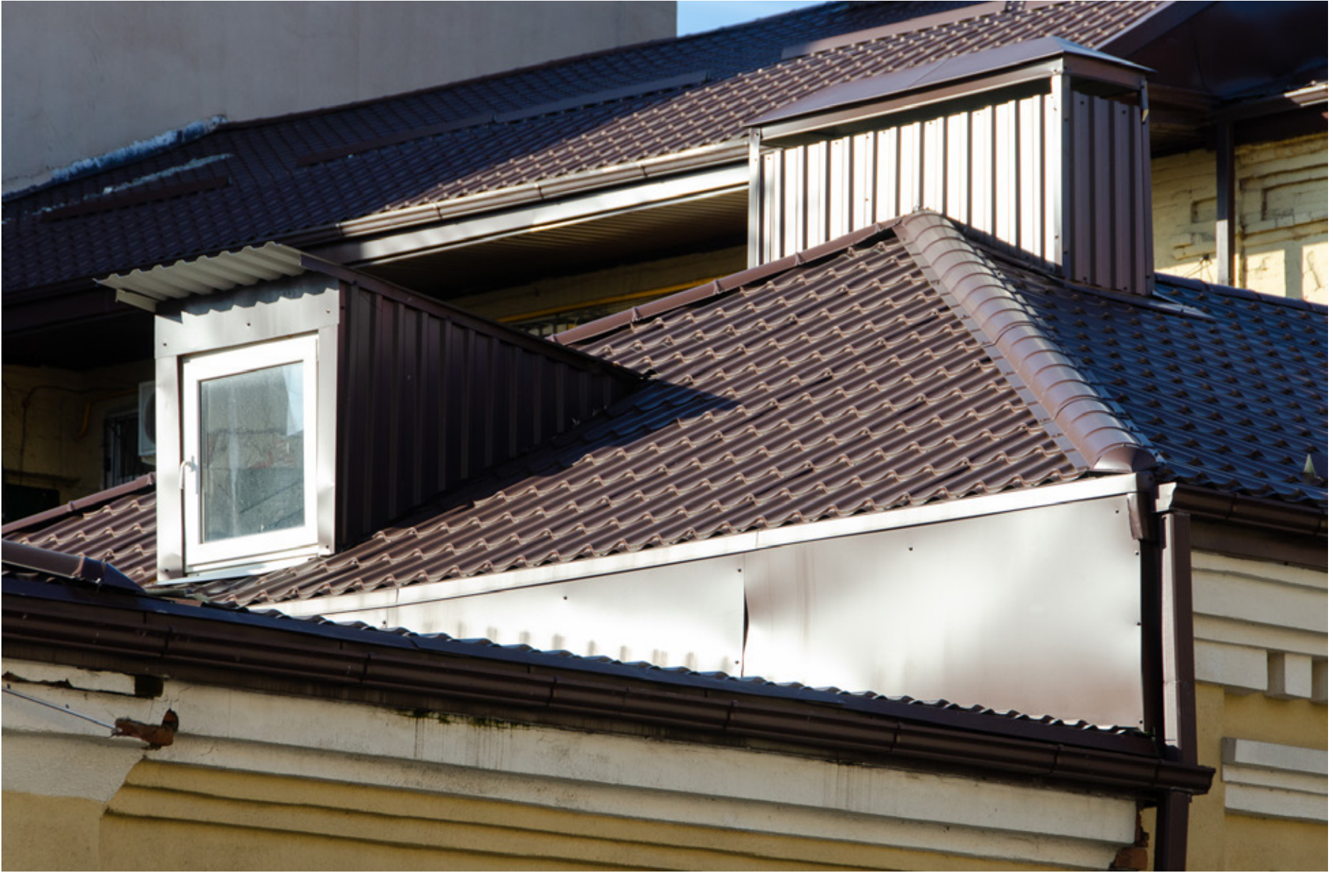
Оригинальные слуховые окна на крыше — заменяют на дешевый металлопластик
