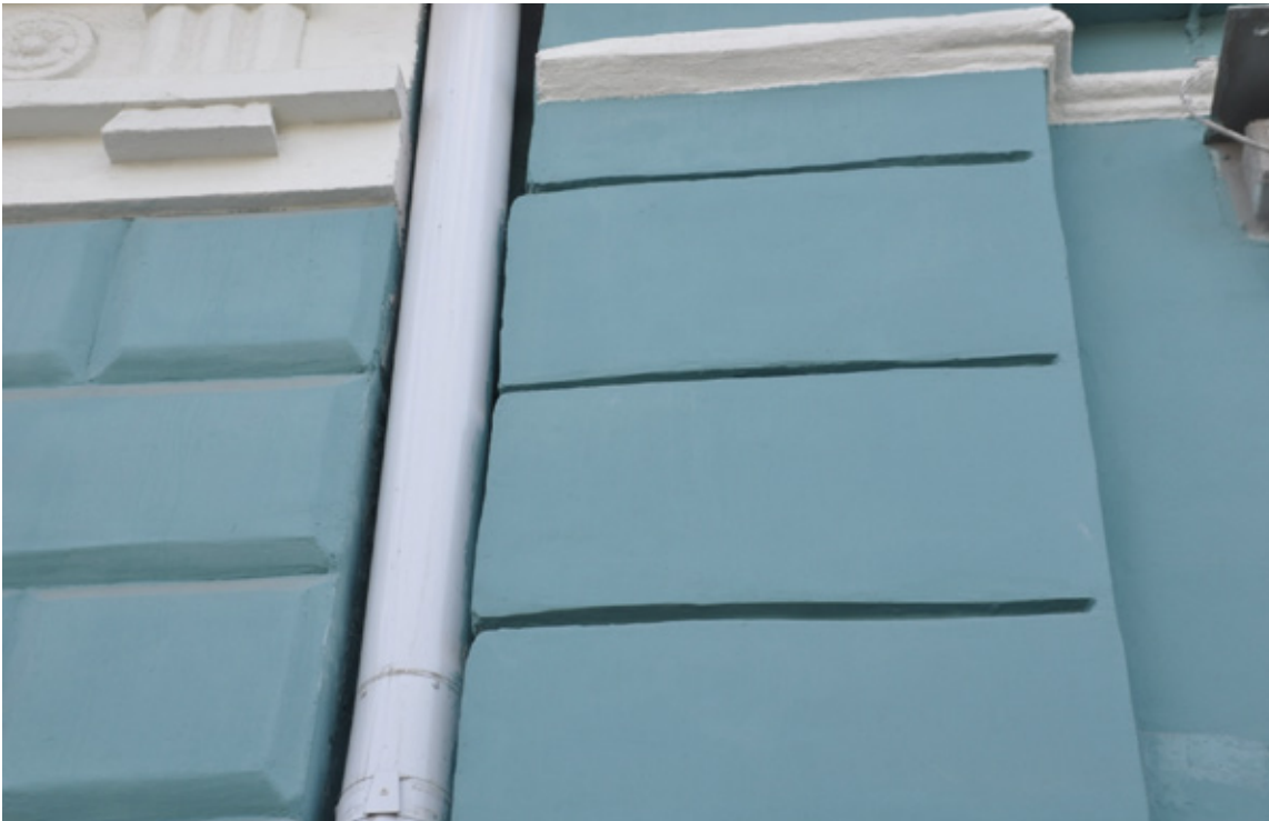
На фото — объект культурного наследия, во время капремонта строители грубо исказили геометрию декоративных элементов фасада.
