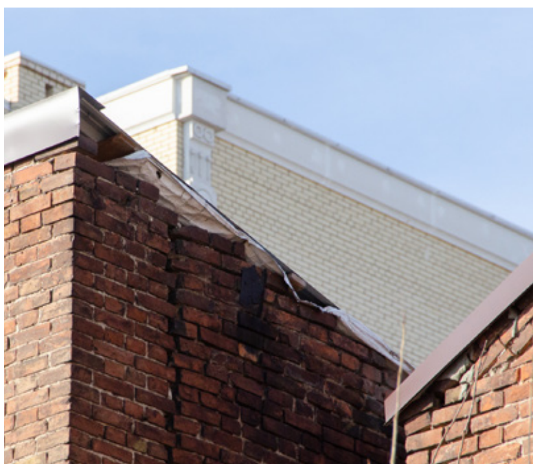
Часть обшивки крыши после ремонта оторвало порывом ветра
