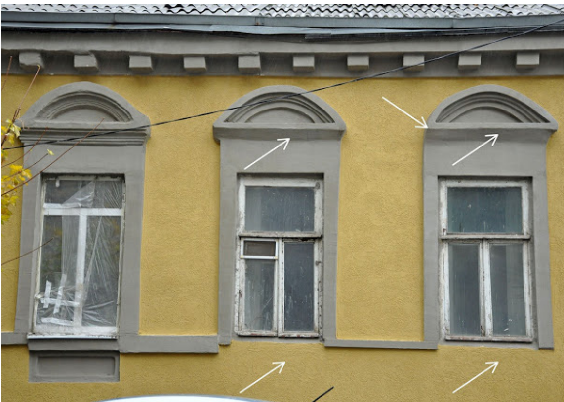
Пример ремонта исторического здания без охранного статуса - декоративные элементы над окнами выведены грубо, под окнами после ремонта остались ничем не восполненные утраты.
