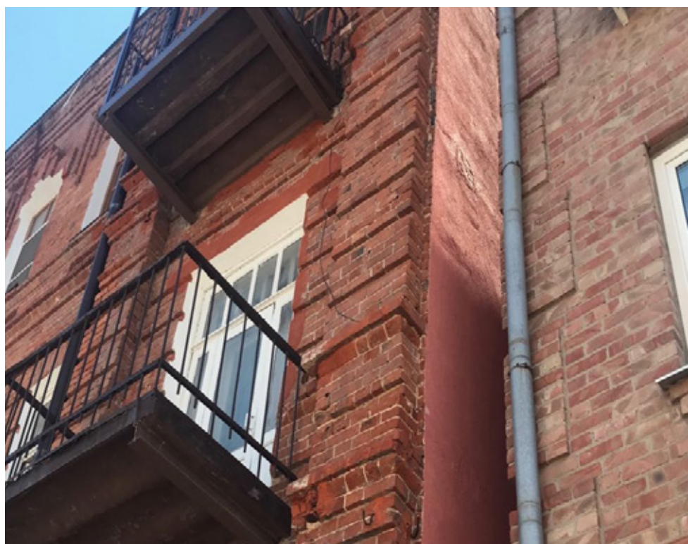
Оштукатуренный торец (боковая часть здания) — бессмысленная трата ваших денег
