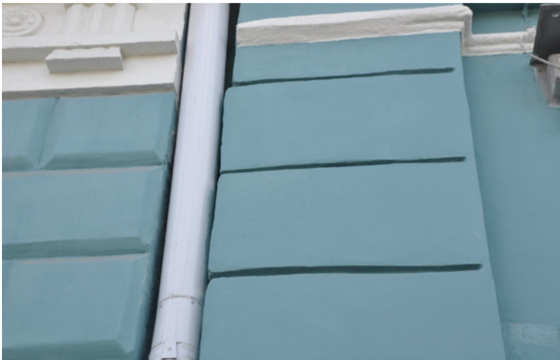
На фото — объект культурного наследия, во время капремонта строители грубо исказили геометрию декоративных элементов фасада.
